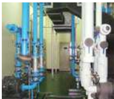
恆溫恆濕工程
