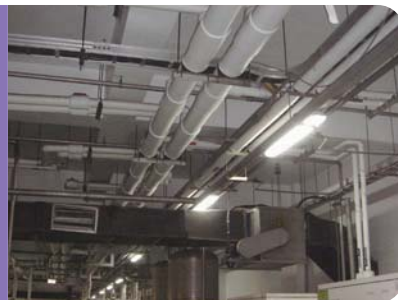
恆溫恆濕工程
